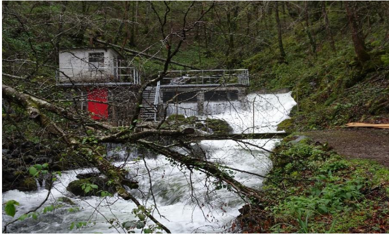
Edifice du captage de l'eau alimentant la ville d'Oloron avec un rejet normal (débit réservé) après une période pluvieuse favorisant cette fois le rejet visible dans les deux déversoirs côté gauche.
